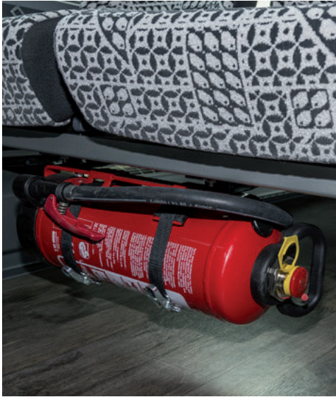
Der Handfeuerlöscher muss regelmäßig (alle 24 Monate) überprüft werden.
